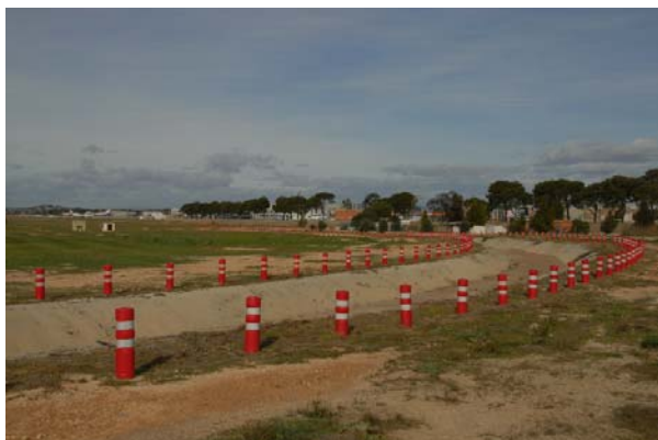
Líneas de drenaje. Valencia
