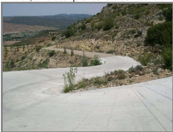
Proyecto de la Conselleria de Medio ambiente "Mejora de la red de infraestructuras de prevención de incendios forestales, mediante la mejora de la pista forestal de Torrebaja a Mas del Olmo, en el monte V-3040, en el T.M. de Ademuz"
