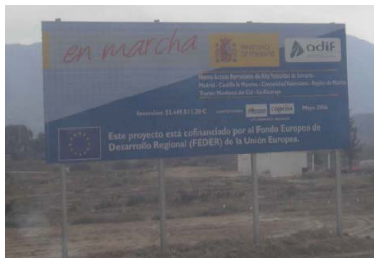
Valla de Obra en las obras de Plataforma del Subtramo Monforte del Cid La Alcoraya
