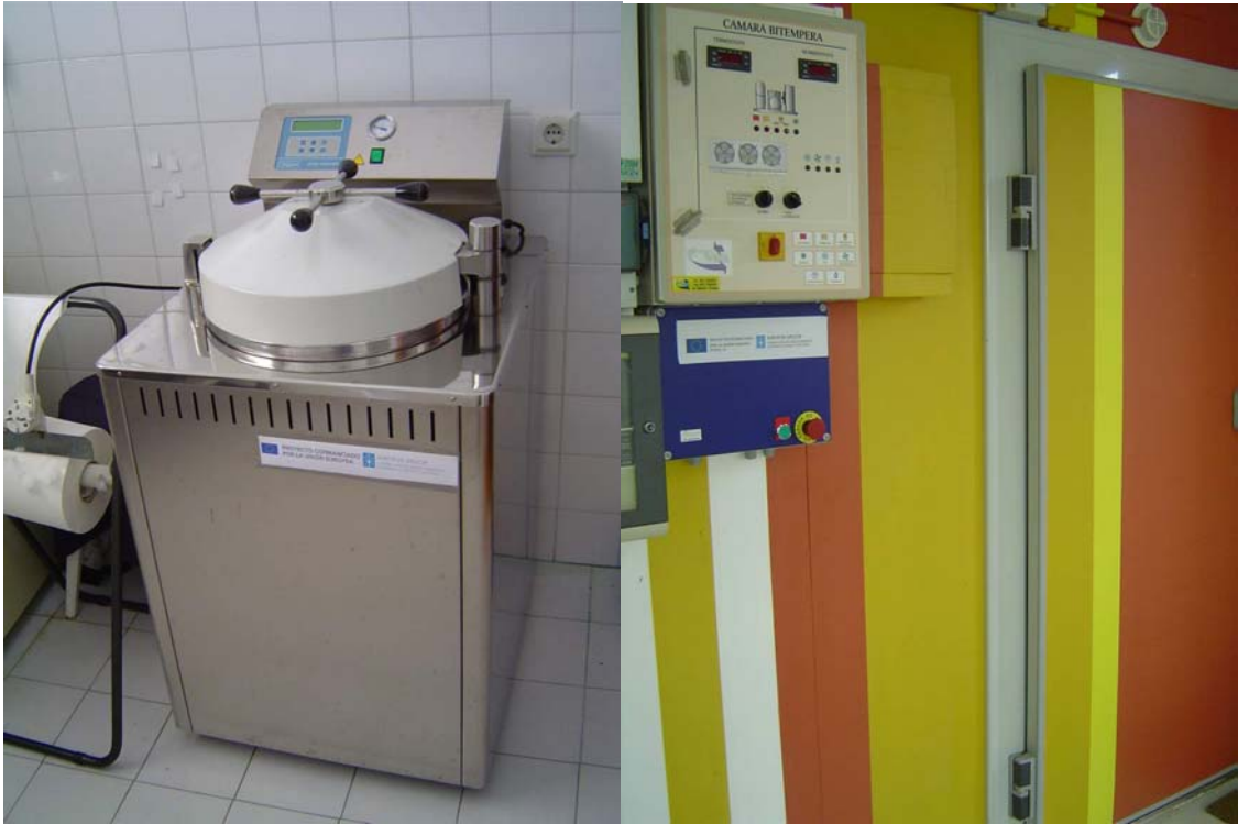
Placas señalando la fuente de financiación FEOGA-O instaladas en autoclave y cámara frigorífica.
