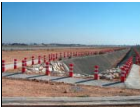
Líneas drenaje. Aeropuerto de Valencia
