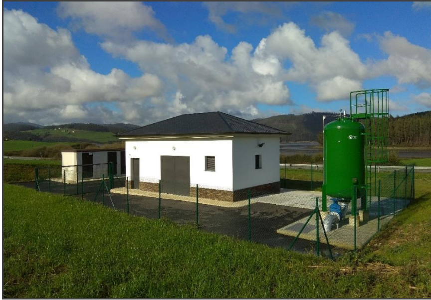
Vista exterior de las instalaciones de bombeo de Vilavedelle
