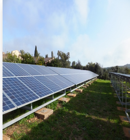
Placas solares en Es Fangar, S.A
