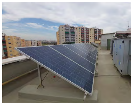
Placas solares instaladas en la cubierta
