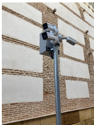
Sistema de control de tráfico rodado mediante cámaras
