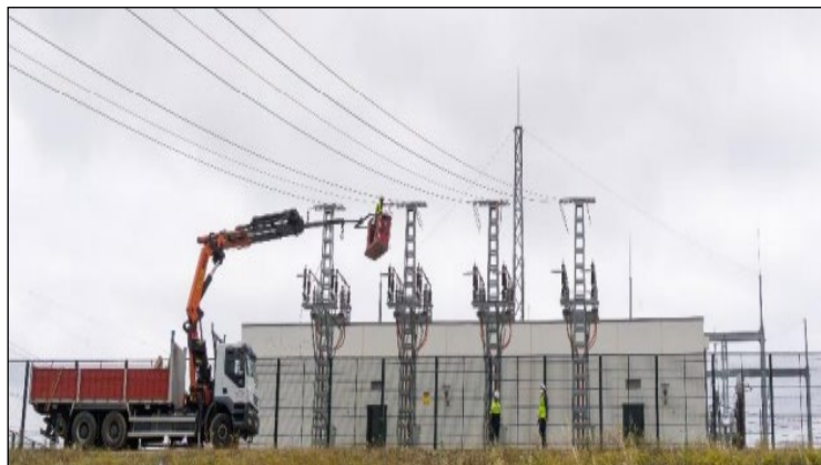
Subestación eléctrica de Cañaveral (Cáceres)
