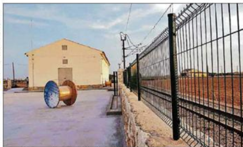
Imagen de la nueva subestación de tracción construida en sa Pobla.
