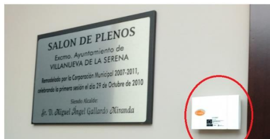
Sensor de temperatura y humedad instalado en el Ayuntamiento villanovense
