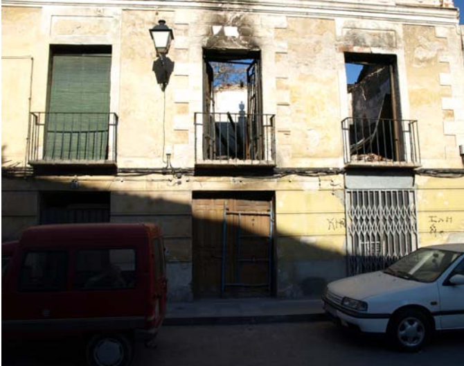
IMAGEN 13. Edificio abandonado y en ruina, Puerta de Cuartos.
