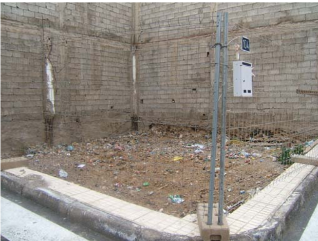
IMAGEN 22. Los residuos procedentes del sector de la construcción, son abandonados en numerosos solares que existen dentro de los núcleos urbanos
