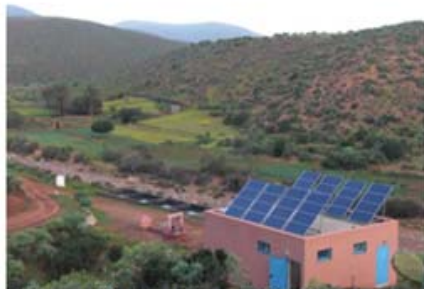
Vista general de sistema de desalación autónomo con energía solar fotovoltaica instalado en un douar de la Comunidad Rural de Amellou (provincia de Tiznit) (Enero 2009) – Marruecos
