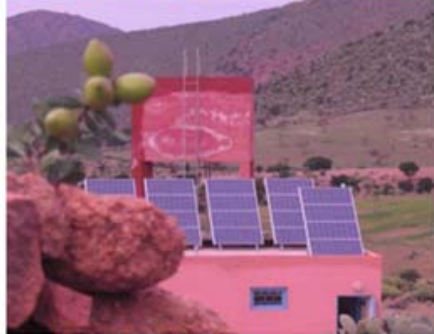
Vista general de sistema instalado en un douar de la Comunidad Rural de Tangarfa (provincia de Tiznit) – Marruecos
