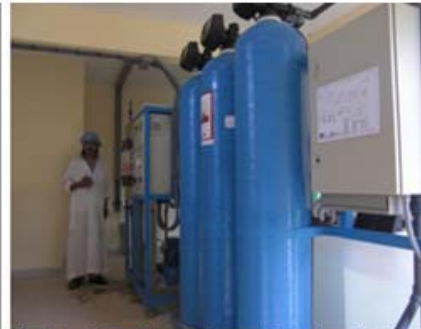
Planta desaladora de ósmosis inversa instalada en la Comunidad Rural de Amellou - Marruecos
