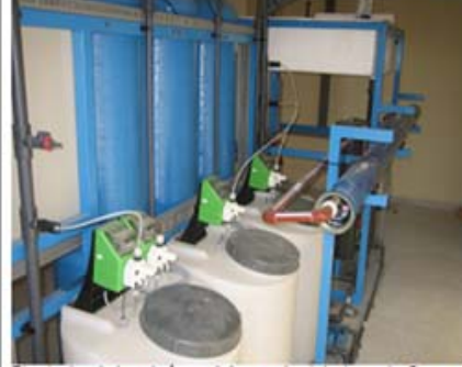
Planta desaladora de ósmosis inversa instalada en la Comunidad Rural de Tangarfa - Marruecos
