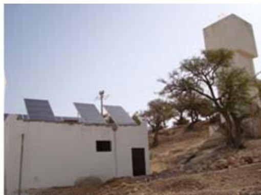
Vista general de sistema instalado en Tazekra (provincia de Fesauira) - Marruecos
