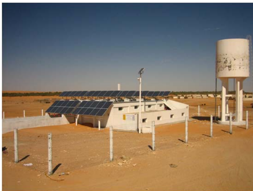
Unidad de 50 mcd instalada en localidad del interior de Túnez (Ksar Ghilâne)
