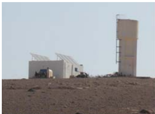
Vista general de sistema instalado en Azla (provincia de Fesauira) - Marruecos
