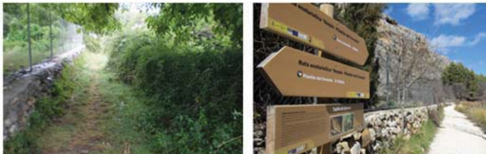
Fotografías del antes y el después: acondicionamiento de senda peatonal con colocación de cartelería informativa y mejora de la accesibilidad para las personas, incluso aquellas con movilidad reducida.
