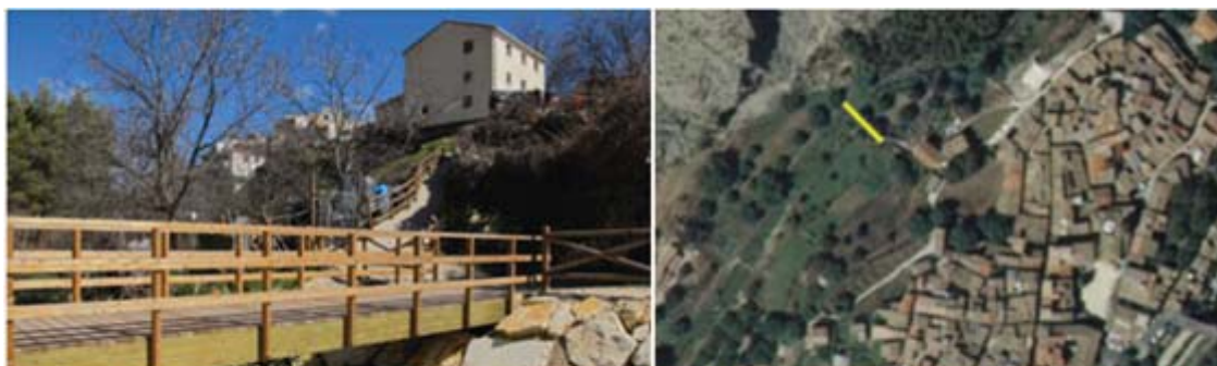
Mejora de accesos desde el municipio de Nerpio, conectividad entre ambas márgenes del río Tajibilla mediante la creación de una nueva pasarela peatonal de madera y mejora de una ya existente.
