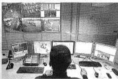
Desde la sala de pantallas se podrá controlar el acceso a los muelles
