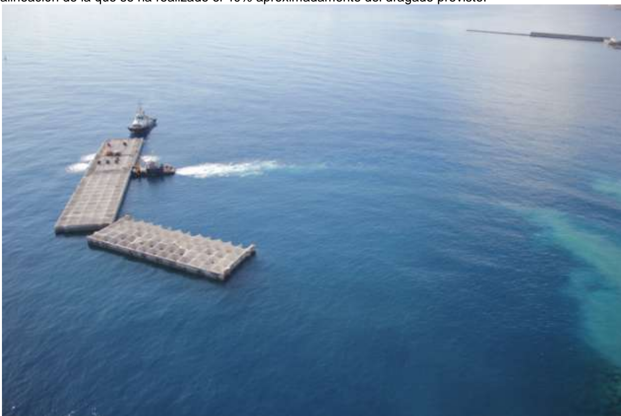
Imagen 2. Foto aérea del los cajones fondeados. Al fondo se ve el contradique con los cajones fondeados.
