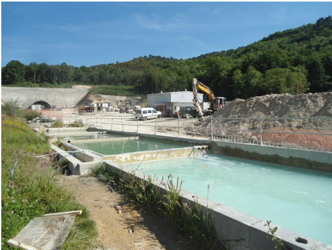
Foto: panorámica sistema de tratamiento en Boca Oeste en el Túnel de Seiró
