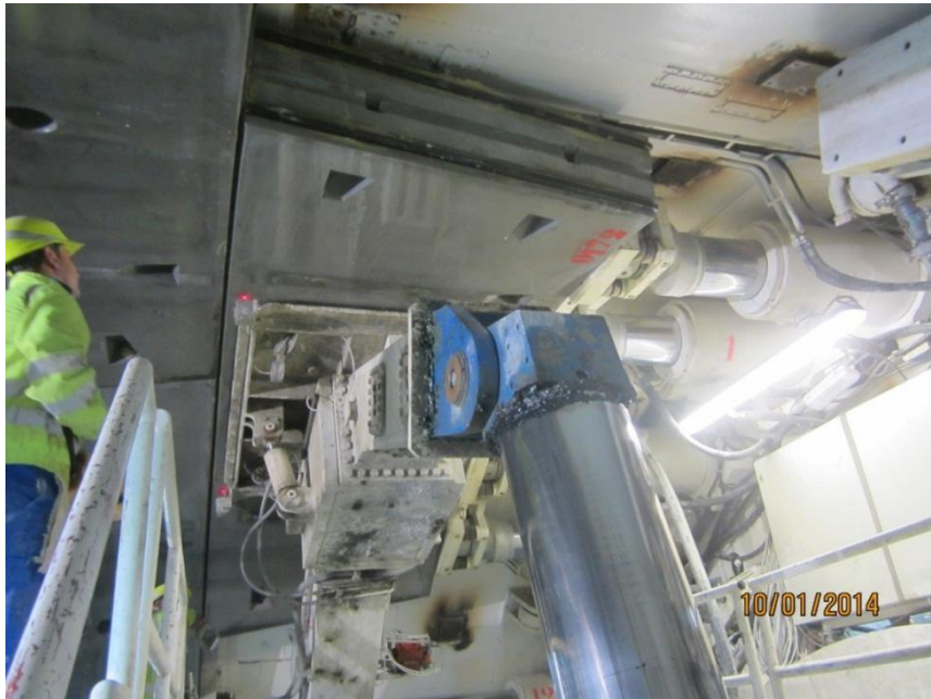
Foto: TBM en fase de montaje de anillo, colocación de una dovela
