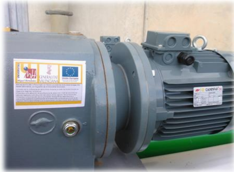
EQUIPO: Sistema de transporte de productos/subproductos húmedos y deshidratados. CAMPUS: Orihuela _Edificio Oriol
