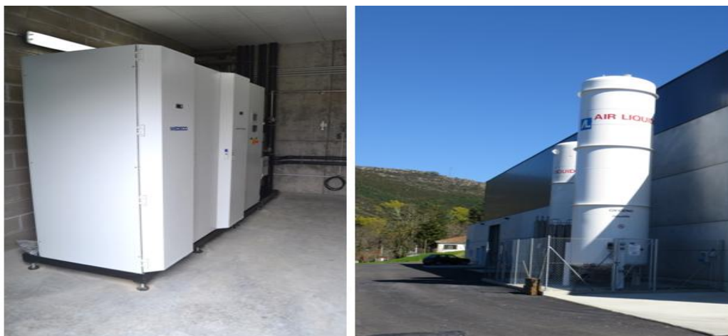
Ozonizador y depósito de O 2 en la ETAP
