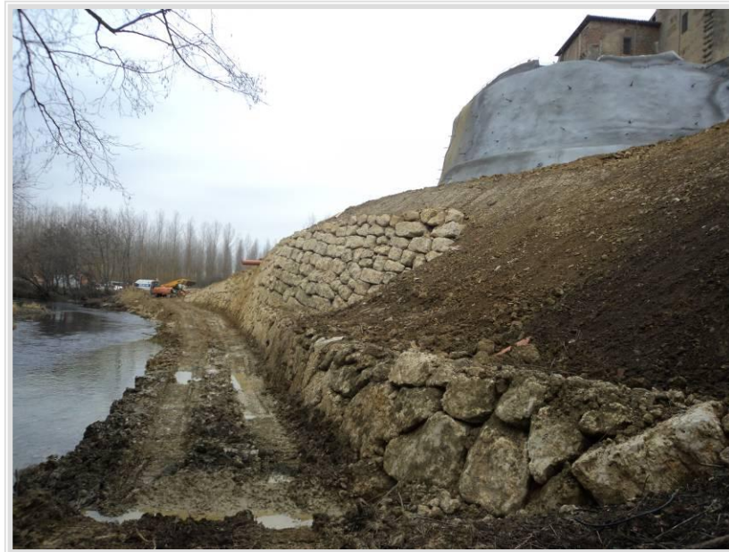
Estabilización de la ladera de la margen izquierda del río Carrión a su paso por Carrión de los Condes.
