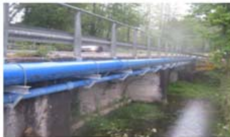
Tuberías de FD grupadas a puente en tramo del ramal de abastecimiento al núcleo de San Salvador de Budiño.
