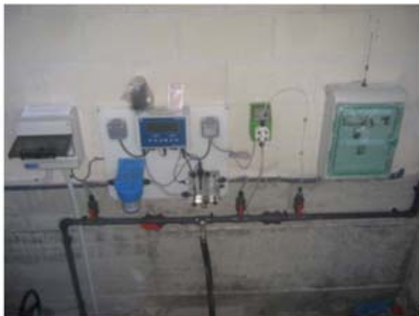
Equipo analizador con regulador de cloro y cuadro eléctrico.
