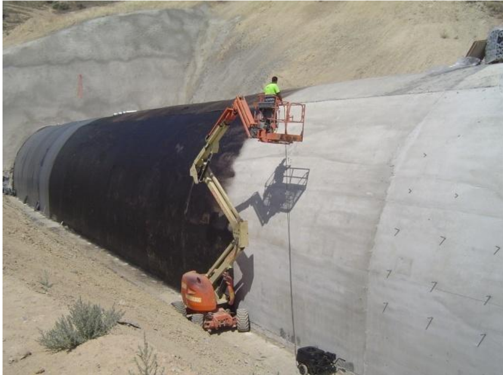
Foto: Operaciones de pintura asfáltica sobre la superficie de hormigón exterior de la bóveda
