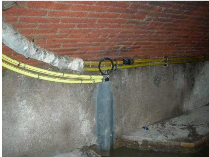
Integración del limnómetro de presión en el colector
