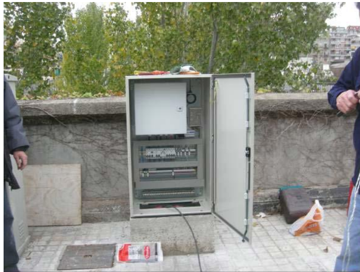
Detalle de armario remota instalado
