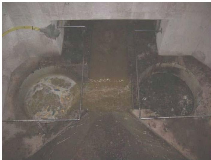
Vista general de funcionamiento de los sifones en régimen normal con la aportación de los tres colectores.
