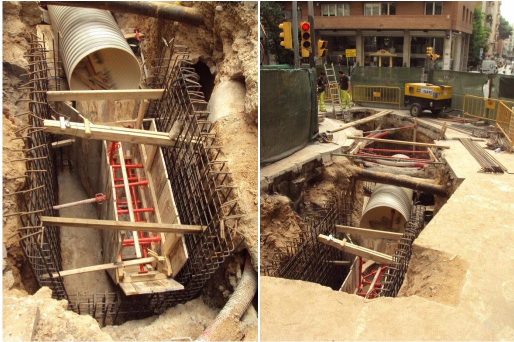
Obra de conexión de la alcantarilla de calle Tavern con Via Augusta
