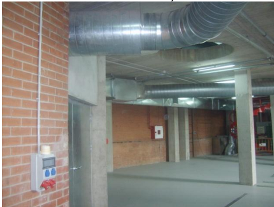
Silenciador conducto de ventilación
