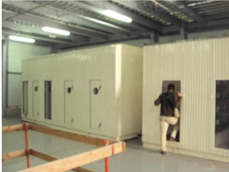
Imagen de las salas compactas de filtros de aire
