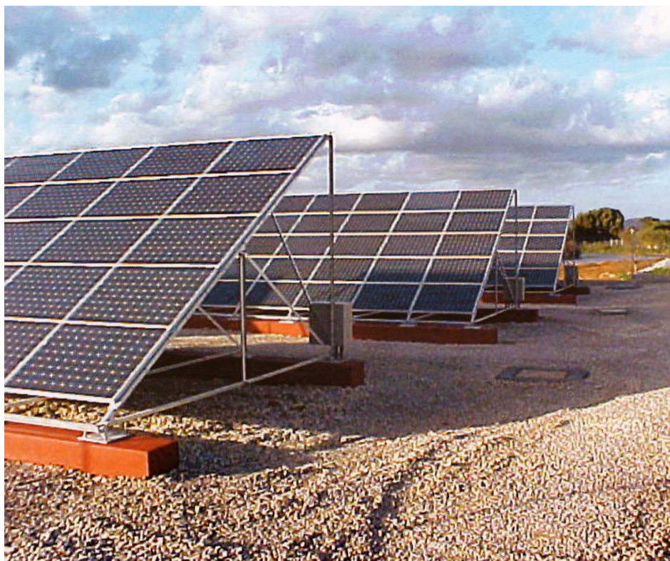
Il·lustració 16. Planta fotovoltaica de Sa Ràpita
