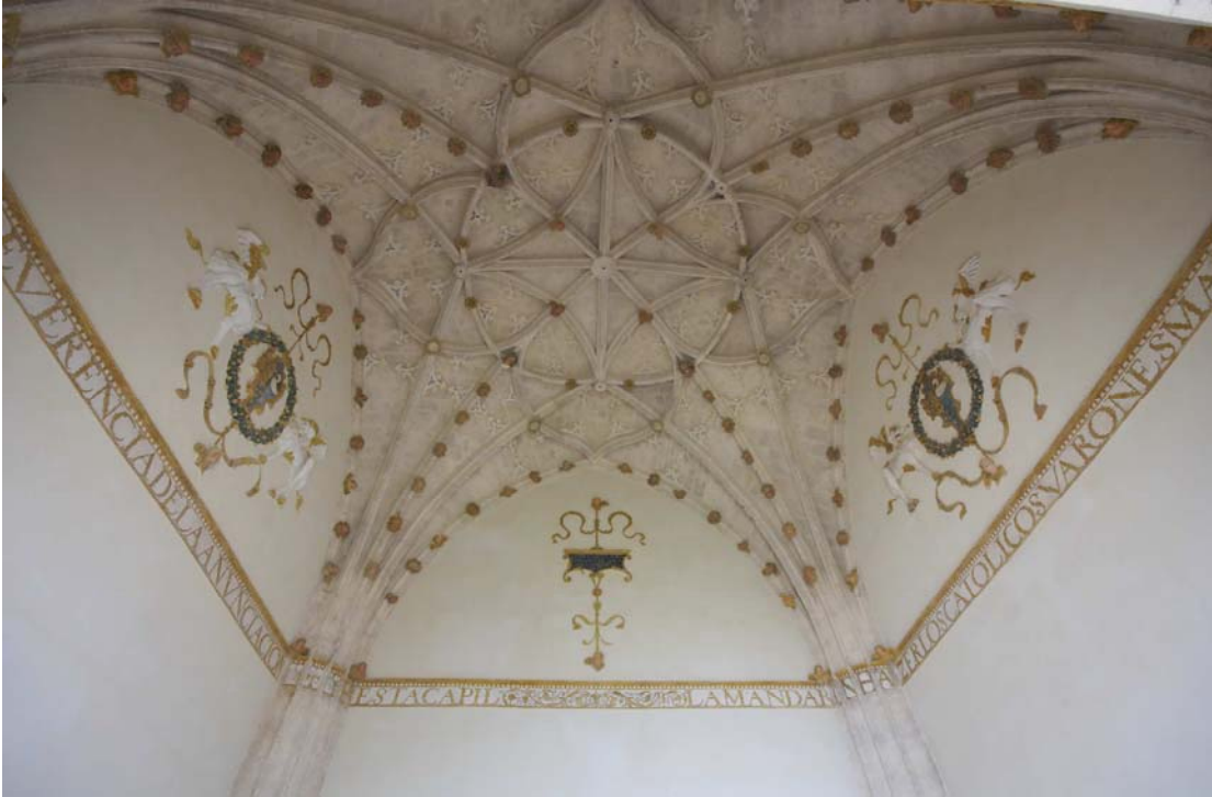
FOTO 9. JAVIER BLANCO. BÓVEDA DE LA CAPILLA DE LOS VILLASANTE. DESPUÉS DE LA RESTAURACIÓN.
