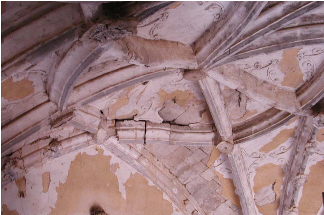
FOTO 8. JAVIER BLANCO. BÓVEDA DE LA CAPILLA DE LOS VILLASANTE. ANTES DE LA RESTAURACIÓN.
