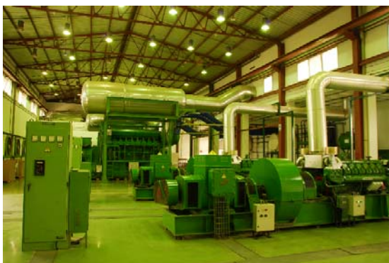
Central Eléctrica. Gran Canaria
