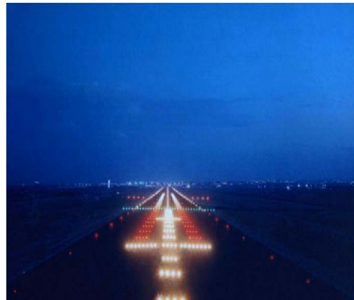
Convertidores en pasarela
