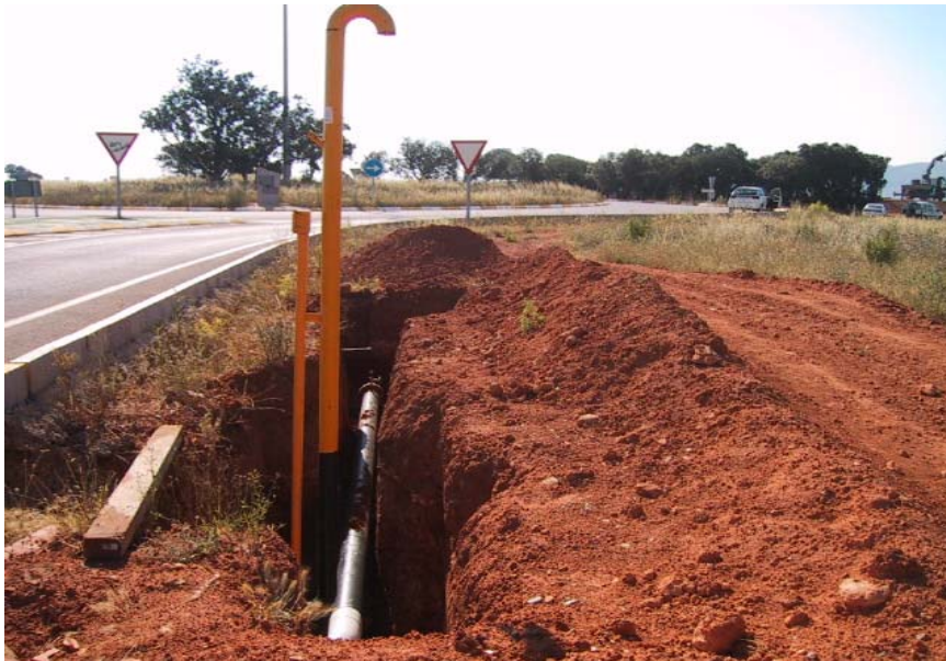
Hito de gaseoducto.
