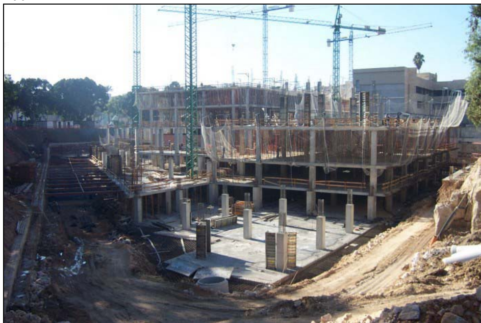
Ilustración 15. Estado de la estructura y la cimentación a finales del año 2001
