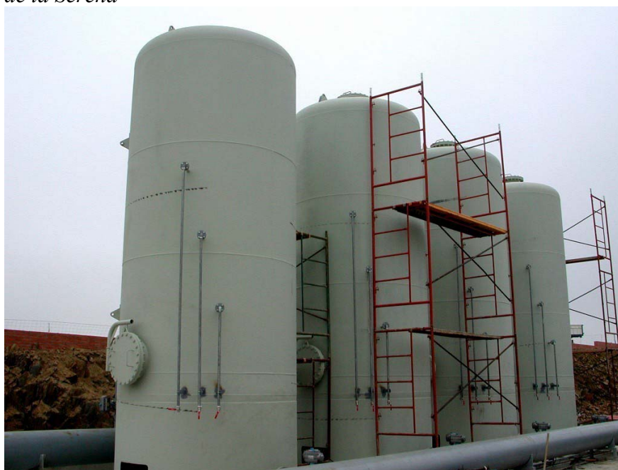
Ilustración 9. Filtros de Carbón en la nueva ETAP de la Mancomunidad de la Serena
