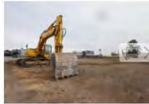
Una pala, ayer, en la parcela donde se construirá la Escuela Superior de Arte. IRMA COLLÍN
