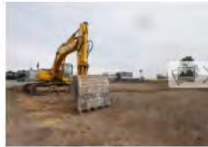
Una pala, ayer, en la parcela donde se construirá la Escuela Superior de Arte. IRMA COLLIN
