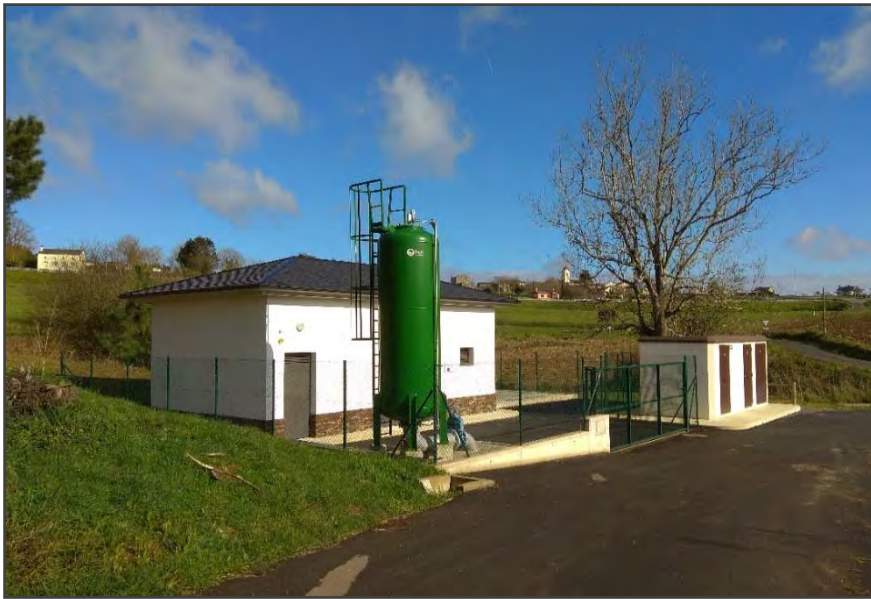
Vista exterior de las instalaciones de bombeo de Aldeanova
