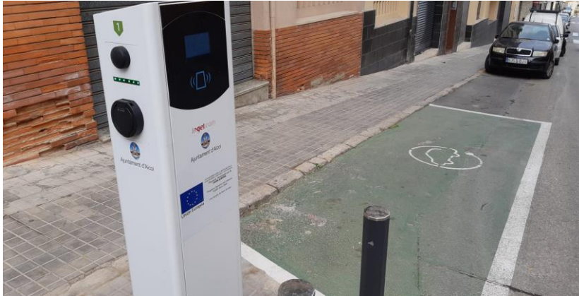
Uno de los cargadores eléctricos en una calle perpendicular a Entenza
