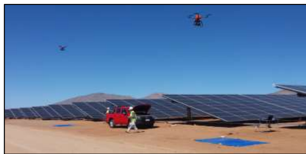
Planta fotovoltaica Acciona Energía
