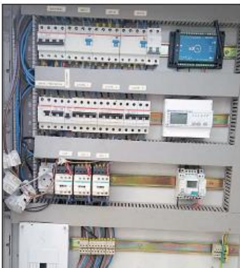
Control en el cuadro eléctrico del alumbrado de La Lastrilla. J. A.
