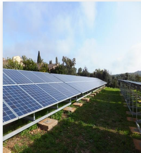
Solar panels in De Salabert e Hijos, S.A.
