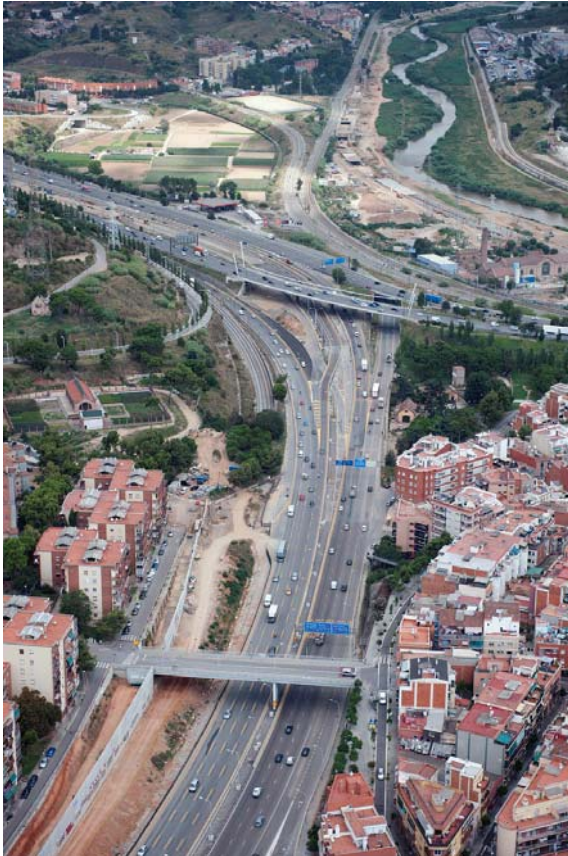
Foto 8: formación de muro izquierdo en la Avda. Meridiana para el desplazamiento de su calzada.
