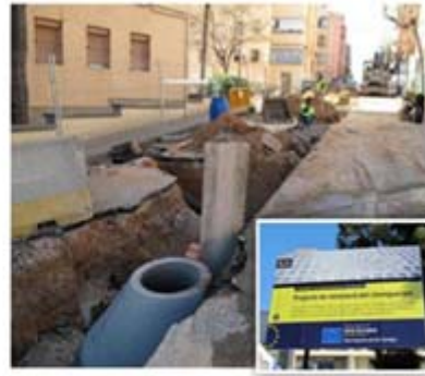
Proyecto de renovación del alcantarillado de las calles de Vinarós y del Pins
