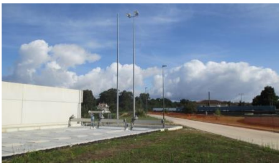
Vista de la instalación de desinfección de la EDAR provisional
