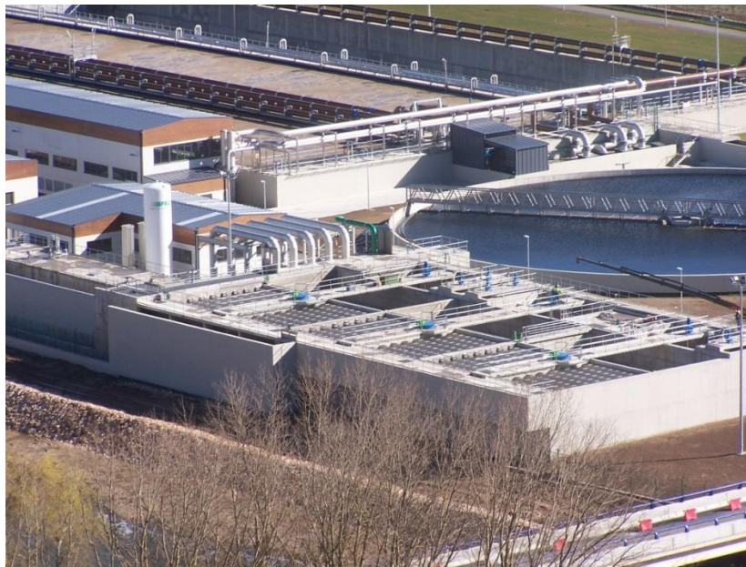
Decantación Lamelar tipo DENSADEG
