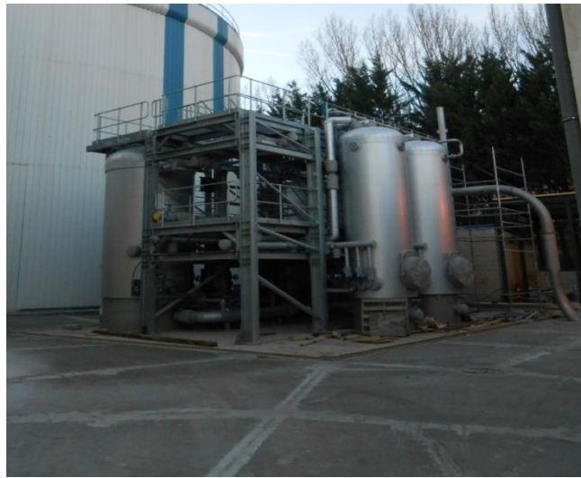
Instalación Hidrólisis Térmica
