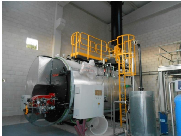
Caldera generadora de Vapor necesario para la Hidrólisis Térmica
