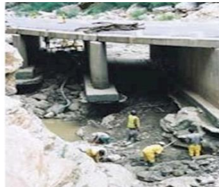
Fallo de un puente por inundaciones en Baviera, Alemania (2005).
