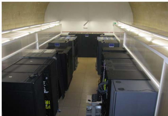
Vista del Centro de Procesamiento de Datos (CETA-Ciemat) con cerramiento de pasillos fríos para mejora de la eficiencia energética del mismo
