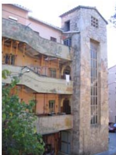
Edificio en estado de ruina antes de su demolición en la calle Palamòs
