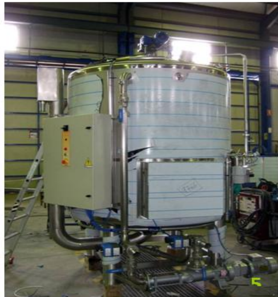
Auxiliar digester anaerobio y Digester anaerobio piloto.
